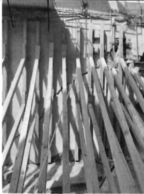
51_Lesione posta sulla facciata fronte Sud prospiciente la via Vallesana
